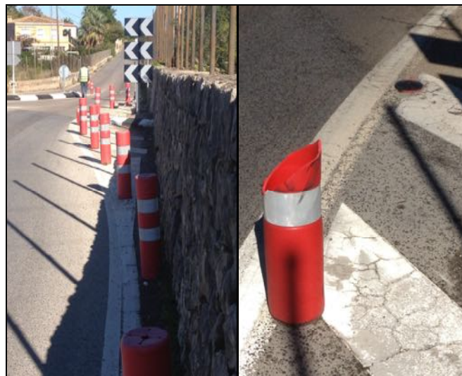
Estado de las balizas a 6-11-2012 y fotografía de una de las balizas rota por la acción del tráfico.
