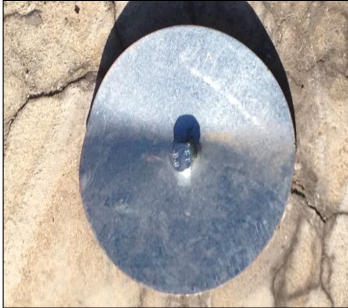
Anclaje de baliza tradicional que queda en la calzada tras ser destruida la baliza.
