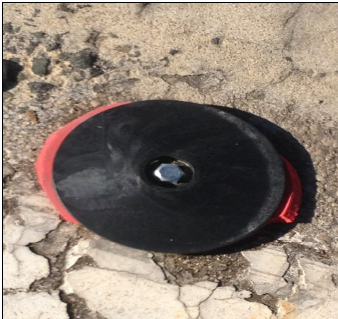
Anclaje de baliza de EVA que queda en la calzada tras ser destruida la baliza.
